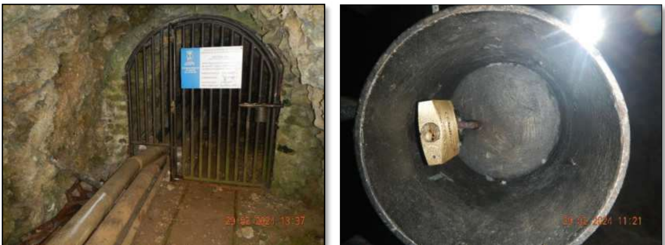
Imagen 2. Estado actual de la puerta (izqda.) y candado y campana de seguridad
